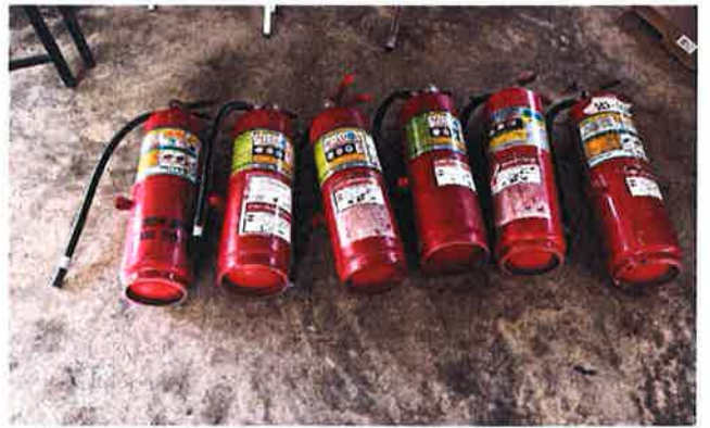
ถังดับเพลิง
