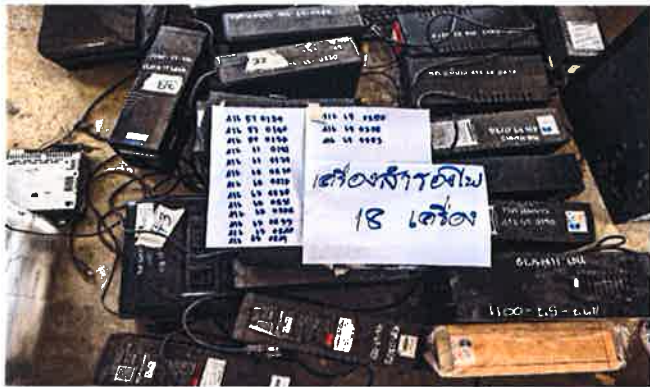
เครื่องสำรองไฟ
